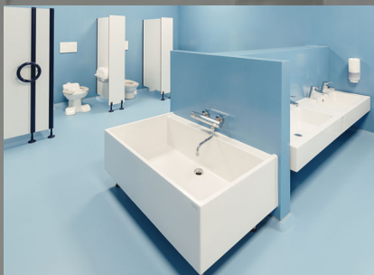
Waschbecken in den Toiletten
